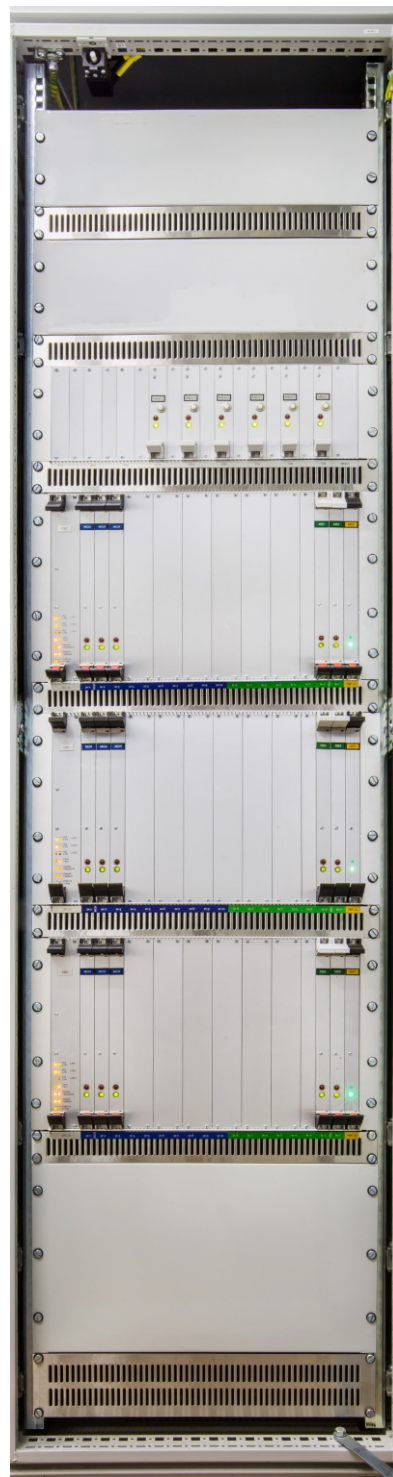
Рисунок №6. Шкаф УСО
